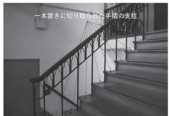
図12 切り取られた手摺の支柱
