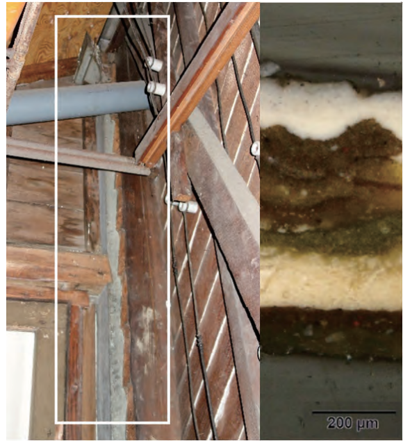
図6 屋根裏部屋柱とその塗膜層（実体顕微鏡写真）
